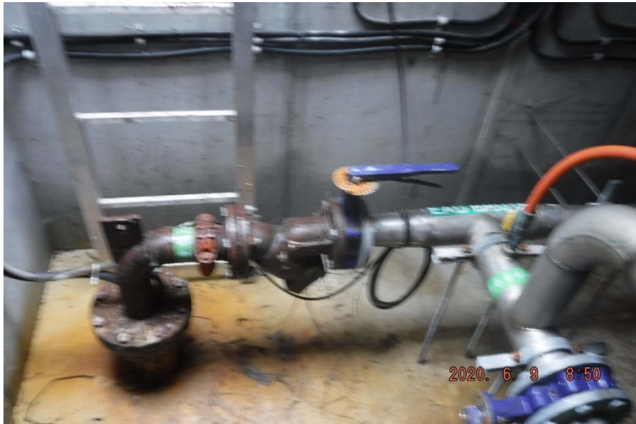
Photo 8 : Vue du tubage du puits P1 (à gauche) et conduite d'eau brute.
